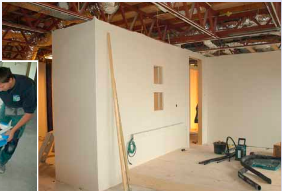
De verhoging waar de balie op geplaatst wordt. Ook zijn de vakwerkspantjes te zien waarop het dak rust.
